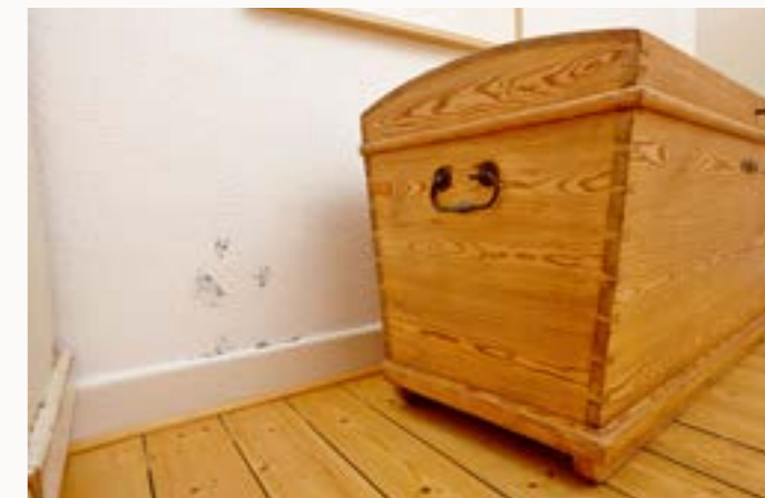
Ein sicheres Indiz für Schimmelbefall sind schwarze Punkte und Verfärbungen. Foto: djd/Mellerud/Marco Rothbrust
