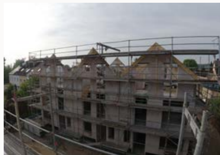
Sichtbarer Baufortschritt: Der Dachstuhl der Reihenhäuser ist, wie das Richtfest es vorsieht, bereits errichtet
