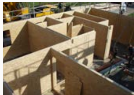
Sicherer Brandschutz – Ihr Haus kostet in der Feuerversicherung keinen Cent mehr als ein Steinhaus!
