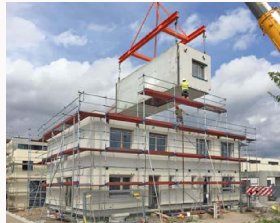
Innerhalb weniger Stunden wird das Haus aufgerichtet. Im Plug-and-Play-System werden die Module dabei zusammen bzw. aufeinander gefügt und die jeweiligen Installationsleitungen und -rohre verbunden. Fotos: Deutsche Hausmanufaktur GmbH
